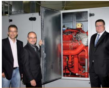
Matthias Stolte, Projektleiter, E.ON Westfalen Weser Energie-Service GmbH, Bad Lippspringes Bürgermeister Andreas Bee und Patrick Hilbrenner, Verwaltungsdirektor Akut des MZG (v. l.), freuen sich über den Einsatz der zukunftsweisenden Technik
